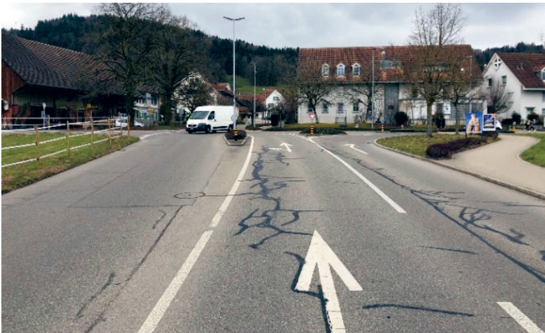
Abbildung 1; Belagsschäden an der Zentrumsstrasse zeigen lediglich die "sichtbaren" Makel
